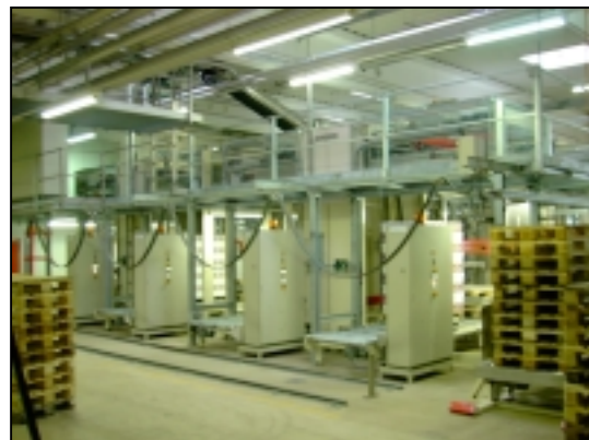
Bild der realen Palettieranlage. Hohe Verfügbarkeit wird durch eine schnelle Störungsanalyse und Fehlerortlokalisierung durch 3D-Darstellung effektiv unterstützt.
